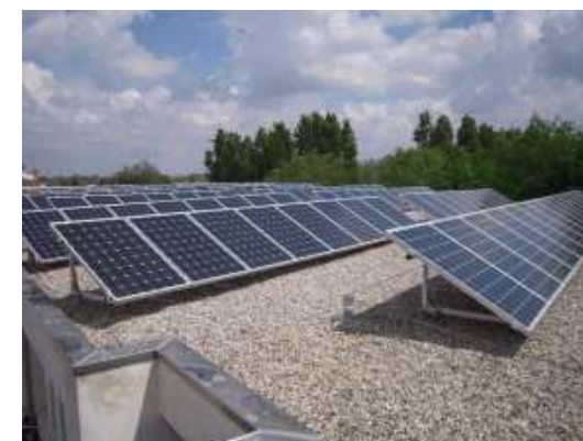
Foto2,3: viste dei pannelli FV sul Tetto della scuola
