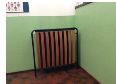
Foto 2: termosifone usato in tutti i locali della scuola, protetto da doghe in legno antiurto
