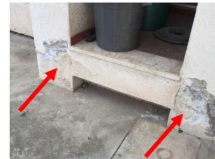
Foto 2: infiltrazioni di umidità
